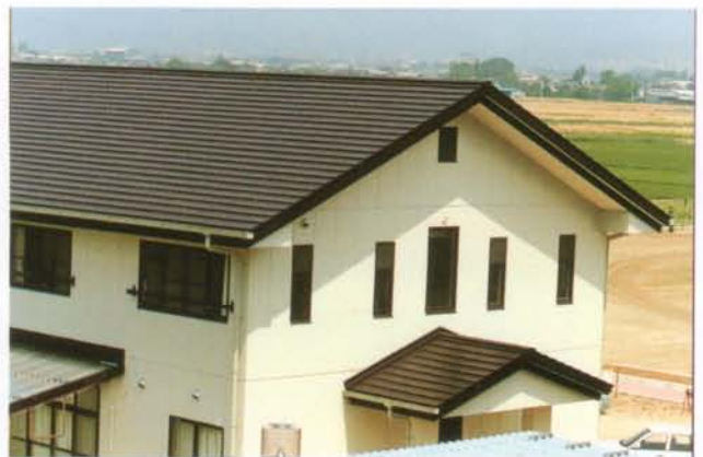
栃木県立小山西高等学校生活指導室 W折段葺300アクリルガルバリウム鋼板
